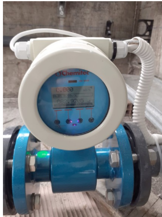
Misuratori di Portata in Ingresso e uscita dall'impianto
