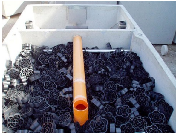
Filtro percolatore Anaerobico
