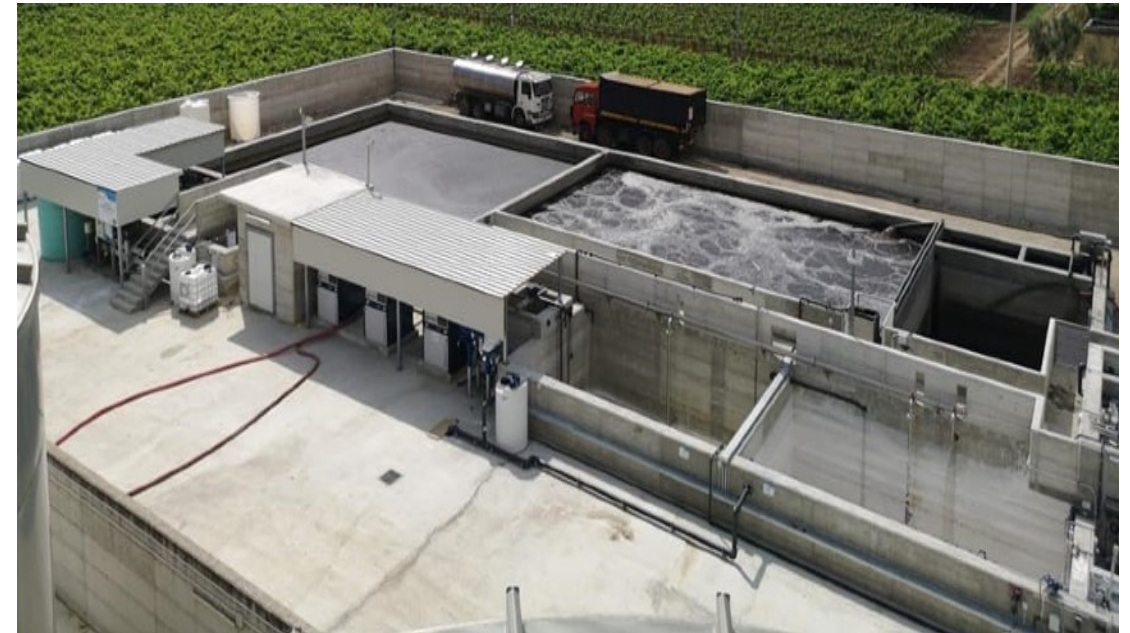
Foto impianto trattamento reflui biologico
